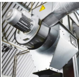
Fläkthuset med motor och rensbus
